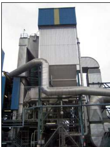
Incineradora da planta de Sogama
